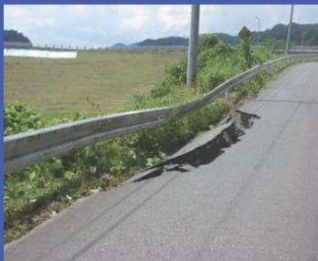
現場に至る道路は寸断されていた
