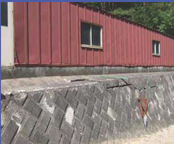
屋内のろ過池も被害をうけた
