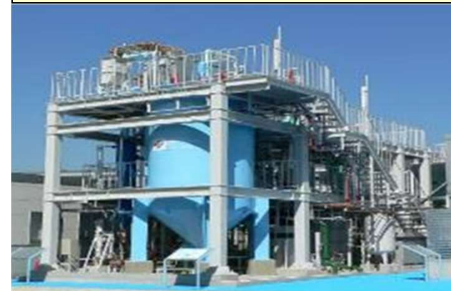
リン回収施設
