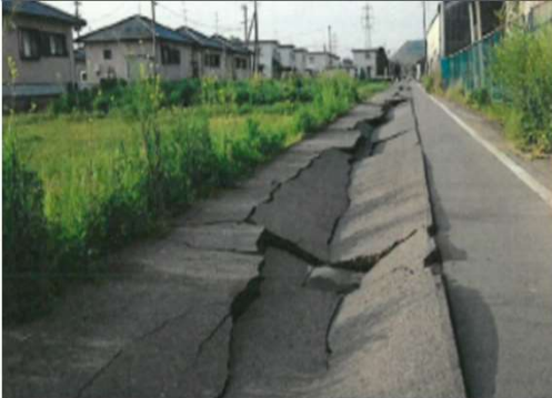
熊本県熊本市(平成28年熊本地震)
