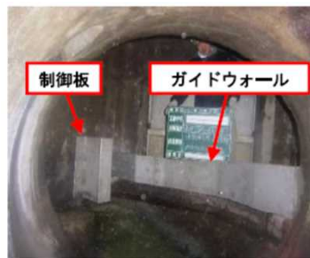
雨水吐に設置するきょう雑物等の除去施設
