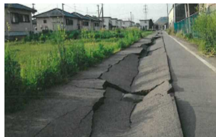
下水管理戻し部の液状化による沈下（熊本県熊本市）
