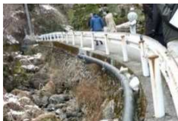
クイック配管 (露出配管)
