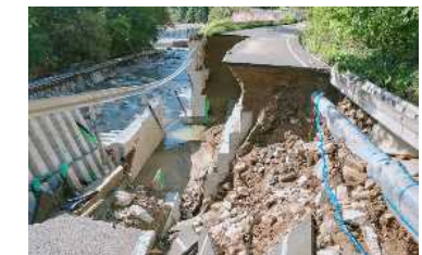
道路崩落等によるアクセス路被災 (宮城県丸森町)
