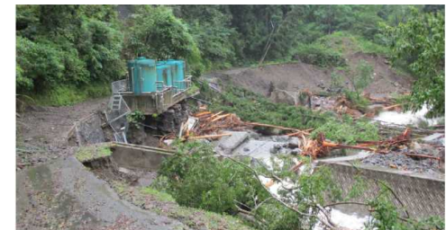
土砂崩れ等で破損した取水施設 (熊本県八代市)
