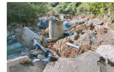
浄水場の取水口流出 (宮城県丸森町)
