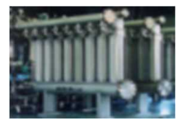
インライン浄水処理
