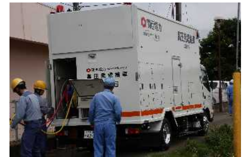
電源車の配備
