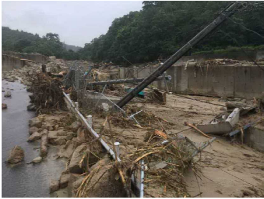
呉市 がれき(土砂や流木)が堆積し 送水機能が停止した柳迫第1ポンプ所
