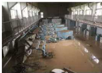
浸水被害を受けたポンプ施設
