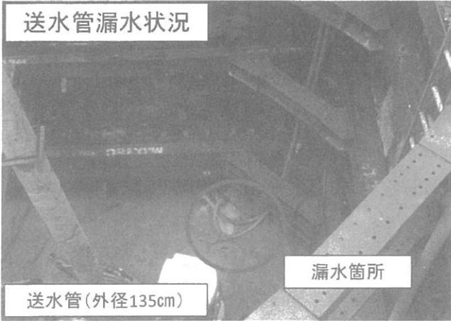
送水管漏水箇所
