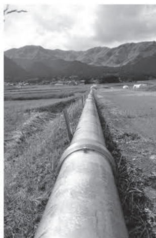
熊本地震の際に活用された仮設配管 シンプルな施工方法で素早い対応につながった
