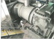
雨水ポンプの整備
