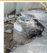
北海道胆振東部地震で液状化した 管路の被害(北海道札幌市)
