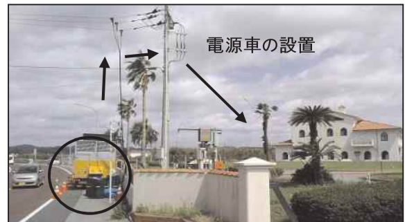
電力会社の電源車による受電
