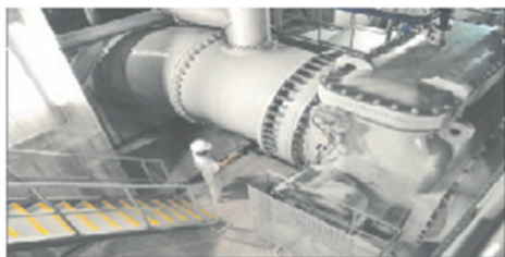
雨水ポンプの整備
