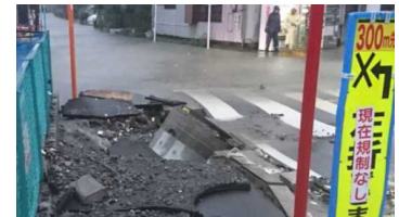
大雨による管路施設の被害状況
