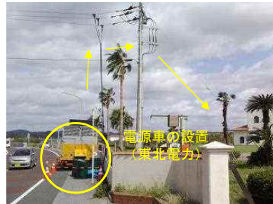
非常時の電源確保 (電源車による受電)
