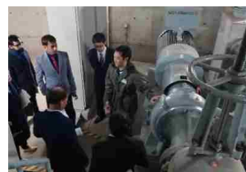
横浜市施設見学(第二ポンプ)
