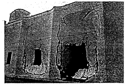
【波圧による破損 (仙台市南蒲生浄化センター)】
