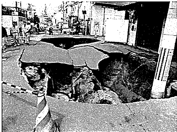
管路の老朽化に起因した道路陥没 平成 23 年 3 月 和歌山県和歌山市
