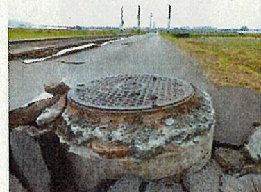
地盤の液状化によるマンホールの浮上 (熊本県益城町)
