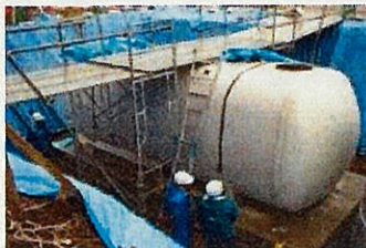
工場製作型 極小規模処理施設
