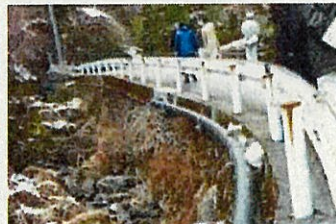
クイック配管 (露出配管)
