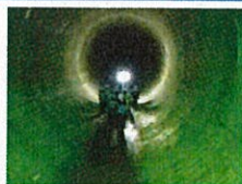
雨水貯留管（東京都）
