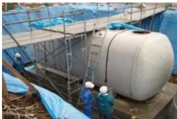
工場製作型 極小規模処理施設
