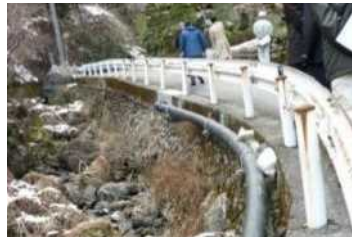
クイック配管 (露出配管)
