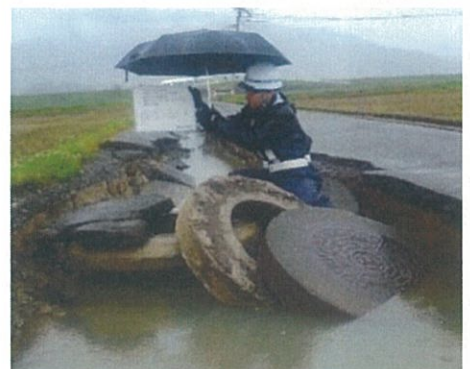
下水管理戻し部の液状化による沈下(熊本県益城町)
