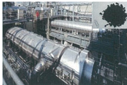
下水汚泥の固形燃料化 (広島市)
