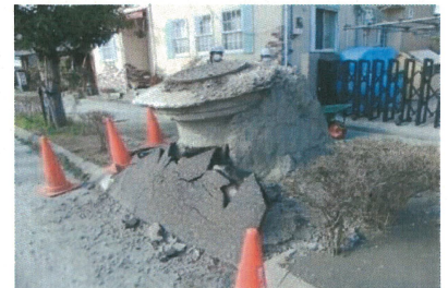
【液状化により隆起したマンホール(浦安市)】
