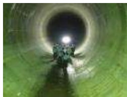
雨水貯留管（東京都）
