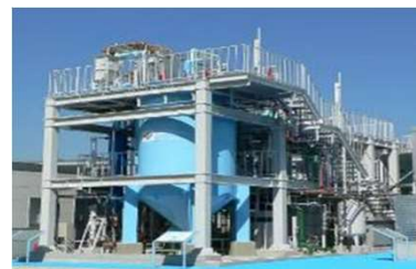
リン回収施設
