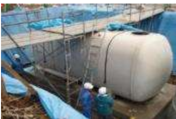
工場製作型 極小規模処理施設
