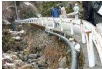
クイック配管 (露出配管)
